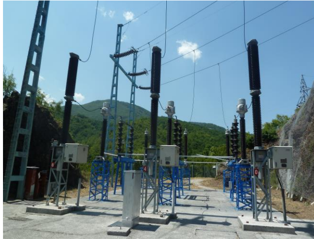
Slika 7.39: 220 kV postrojenje HE "Bistrica"
