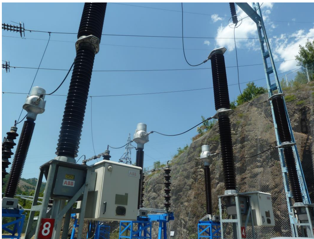
Slika 10.24: Fotografija visokonaponskih elemenata postrojenja 220 kV HE "Bistrica"
