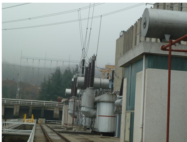
Slika 7.1: Blok transformator snage 380 MVA /190 MVA /190 MVA sa delom mašinske zgrade
