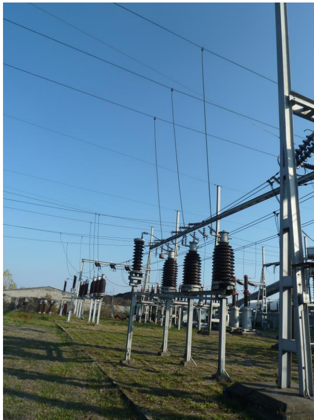
Slika 10.19: Fotografija strujnih i naponskih mernih transformatora na izlazu iz postrojenja 110 kV TE "Morava"
