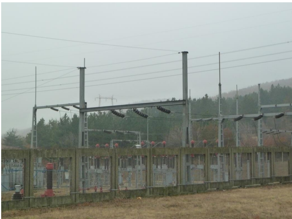
Slika 10.14: Fotografija gromobranskih elemenata (štapnih hvataljki i zaštitne užadi) postrojenja 110 kV HE "Đerdap 1"
