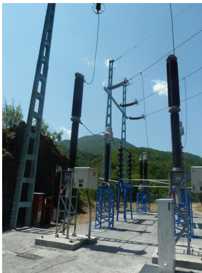
Slika 10.26: Fotografija prihvatnog sistema u vidu dva zaštitna užeta iznad postrojenja 220 kV HE "Bistrica"
